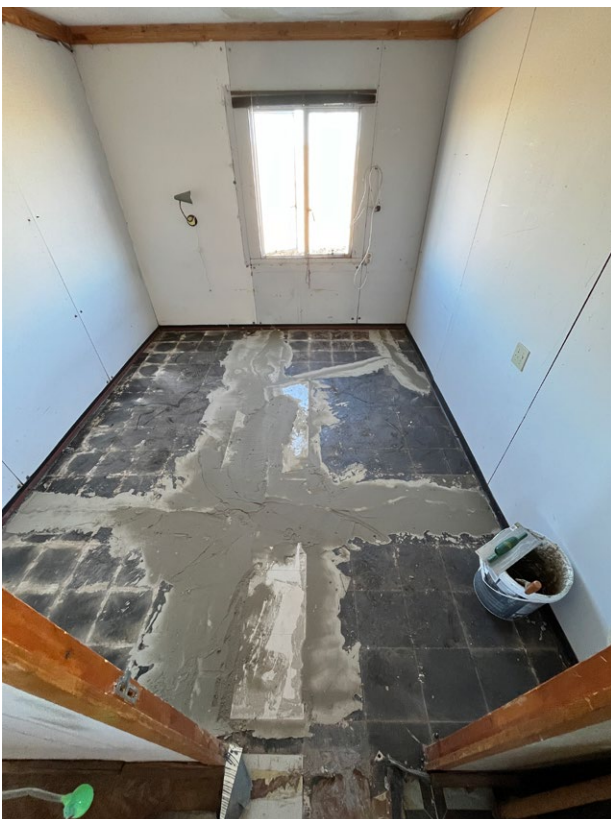
Abb. 1: Die Risse im Boden sind mit Spachtel verfüllt
